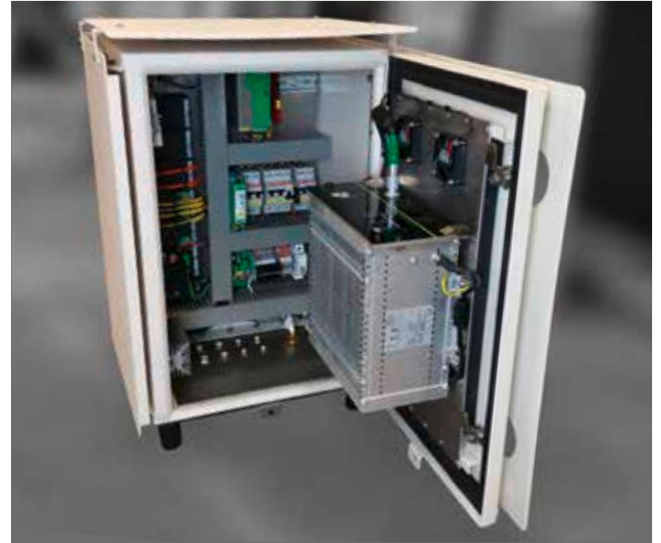
▲ Die M1-Steuerung ist im Schaltschrank untergebracht.
