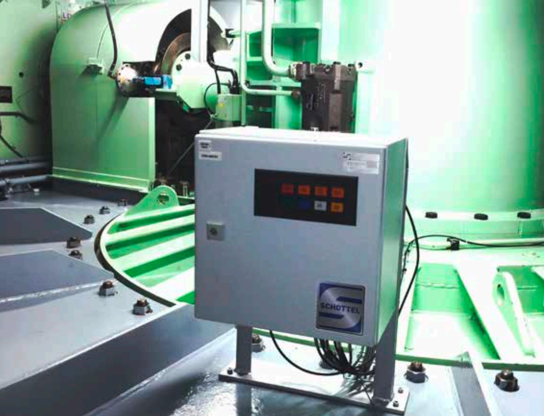
◀ Im Maschinenraum sind die Sensoren für Wartungszwecke leichter zugänglich.
