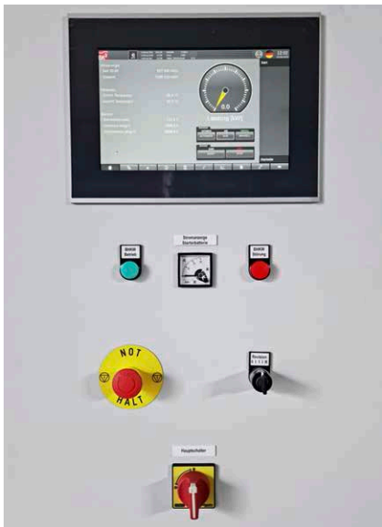
Übersichtlich und selbsterklärend: Bedienerführung am neuen Touchpanel der BK³-BHKWs.
