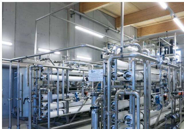
Das Wasserwerk in Kittsee vereint neueste Technik mit moderner Architektur.
