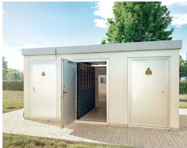
Batteriespeicherstation des Schweriner Energieversorgers WEMAG mit einer Primärregelleistung von 500 kW und einer Kapazität von 925 kWh.
