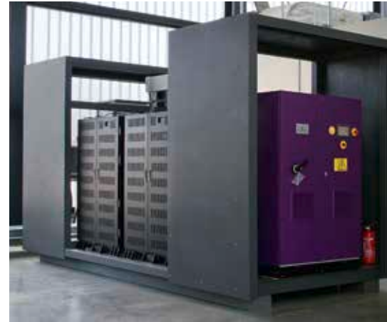
Teststand für Lithium-Ionen-Batterien im Younicos Technologiezentrum in Berlin-Adlershof.
