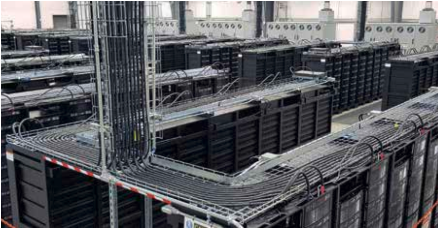
Ein Blick in den 36-MW-Batteriepark Notrees – der größte an einen Windpark angeschlossene Batteriespeicher in den USA.
