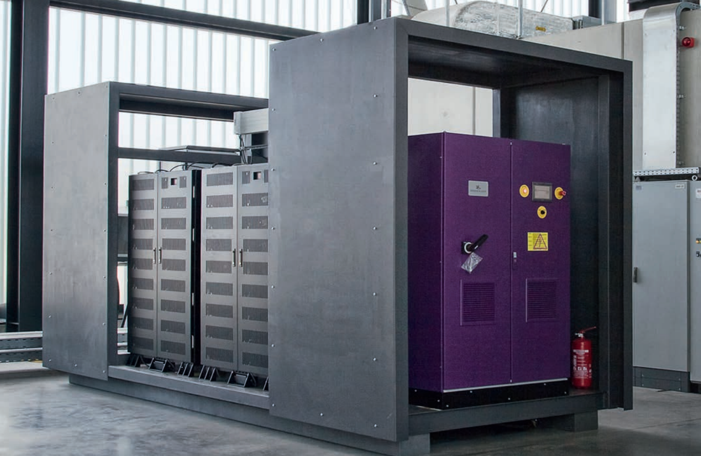
▲ Übermannshöhe Module: Batteriespeicher in Lithium-Ionen-Technologie, wie sie im Batteriepark der WEMAG in Schwerin eingesetzt werden.
