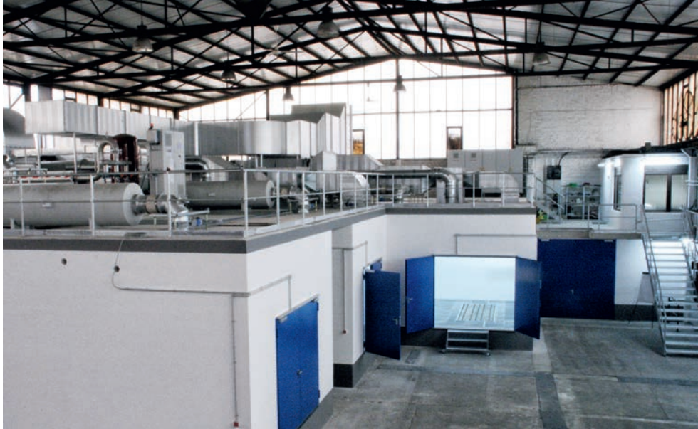
▲ Eindrücklich: Prüffeld der GVH mit drei Prüfständen und den Versorgungseinrichtungen (Lüftung, Kühlung, Abgasabsaugung, Kraftstoffversorgung) auf dem Dach.
