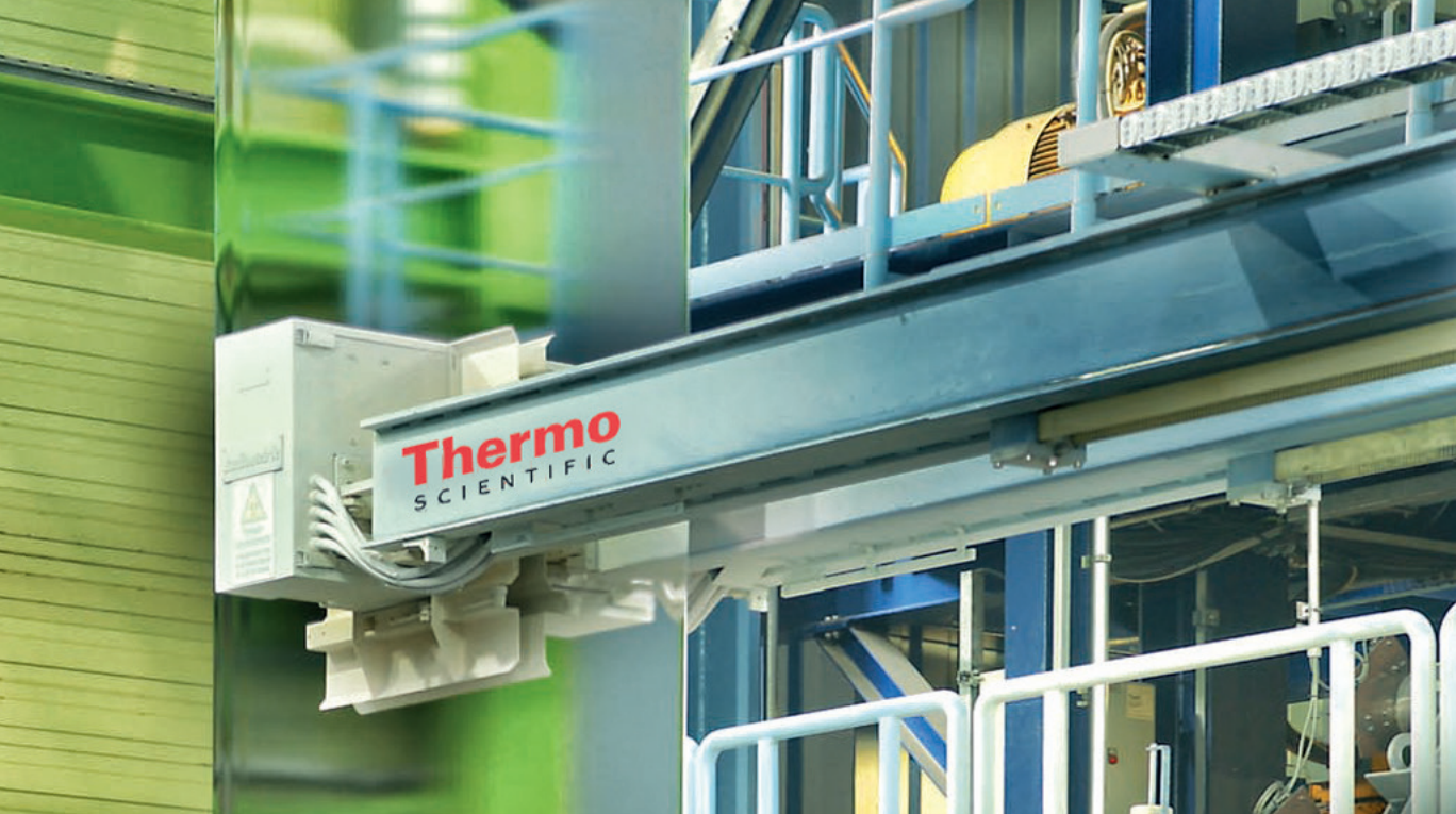
▲ Thermo Scientific RM310EH Röntgen-Heißmesssystem, installiert direkt über dem Zinkbad einer Feuerverzinkungslinie. Das System misst berührungslos die Flächenmasse des noch flüssigen Zinkauftrages auf dem Stahlband. Auf Basis der Messwerte wird der Zinkauftrag geregelt.
