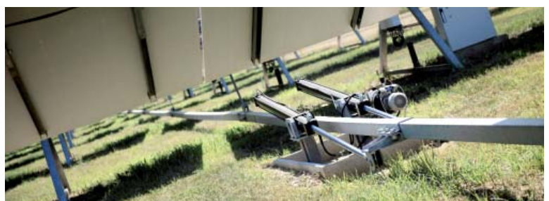
▲ Elektronisch gesteuerte Nachführungen der Solarmodule verringern besonders in den Morgen- und Abendstunden die Verschattung der Module und verbessern so die Gesamtleistung des Kraftwerks.
